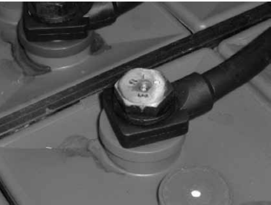
Signe de surchauffe de la batterie: vis décolorée
