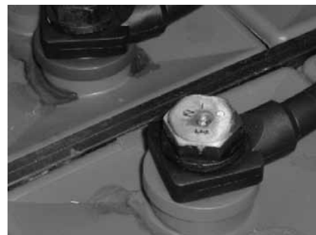
Indizio di surriscaldamento della batteria: vite di colore leggermente diverso.
