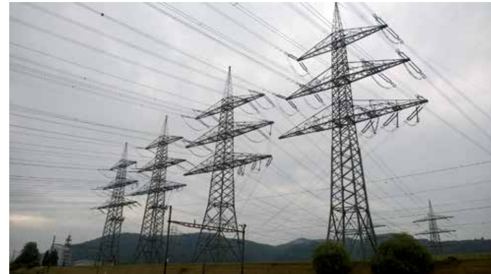
Leitungen in Laufenburg
